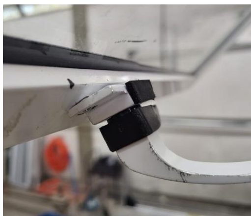
Figura 4 – Afrouxamento da maçaneta
